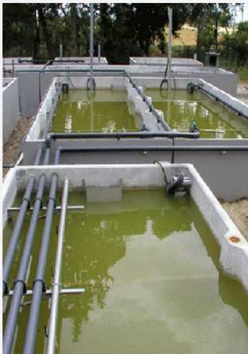
Vasche di depurazione
