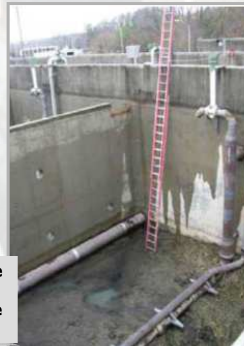
Vasca di aerazione di un impianto trattamento acque reflue
